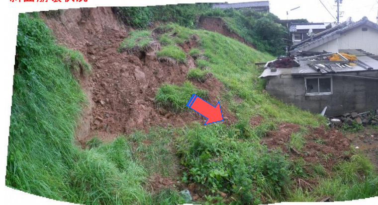
斜面崩壊状況
