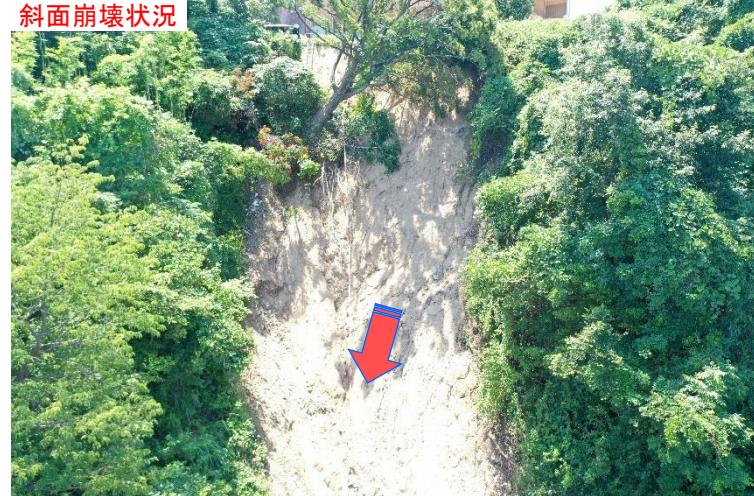
斜面崩壊状況
