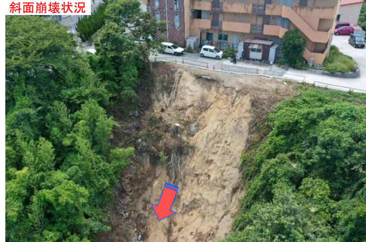
斜面崩壊状況
