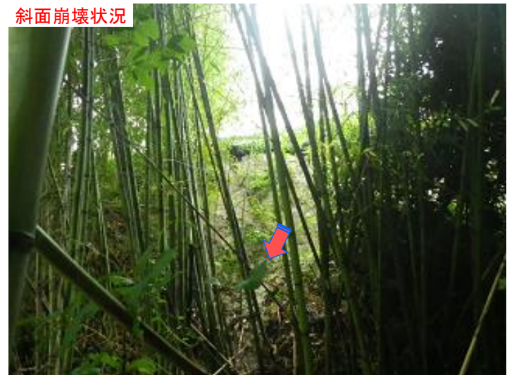
斜面崩壊状況
