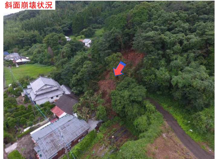
斜面崩壊状況
