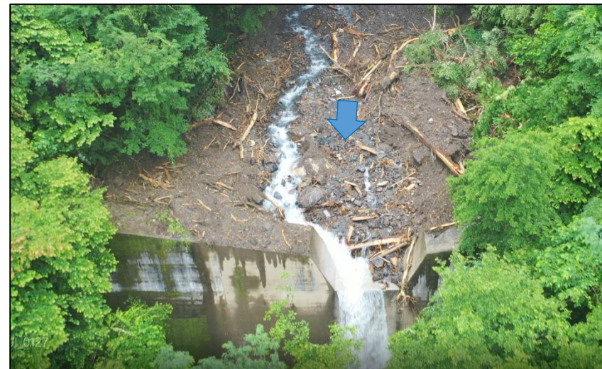
土石流発生後
