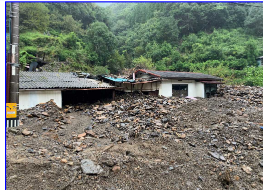
9/19 土石流等 宮崎県西米良村村所
