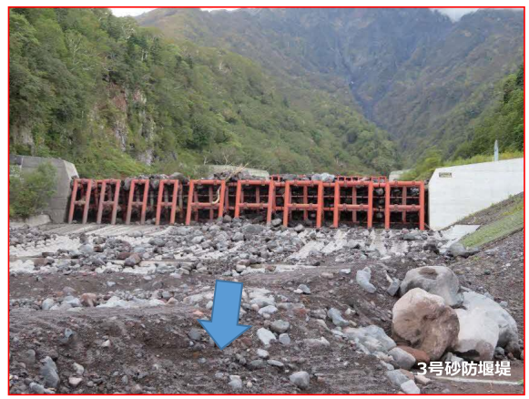
土石流発生後(令和5年9月29日 撮影)
