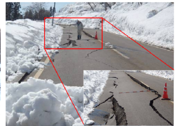
津南町田中地区地すべりにて道路に発生したクラックの状況 9
