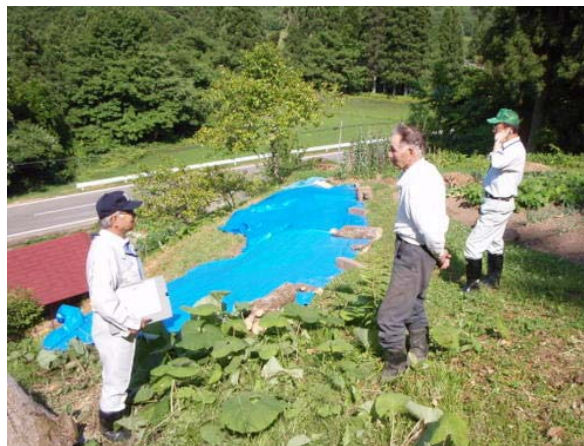
応急対策状況（岩手県奥州市衣川区大平）
