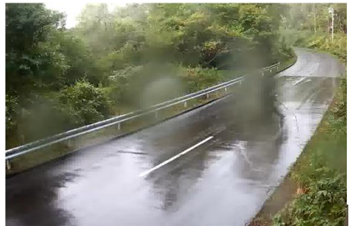
豪雨時の市道亀裂箇所の様子
