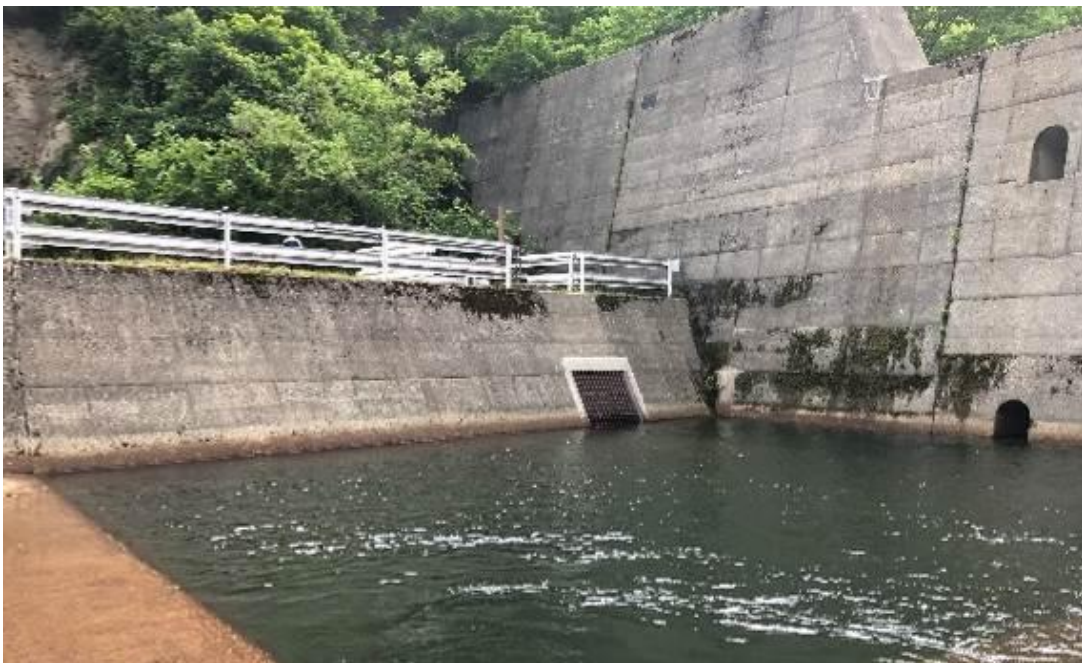
写真-6 側方取水方式による取水設備設置例
