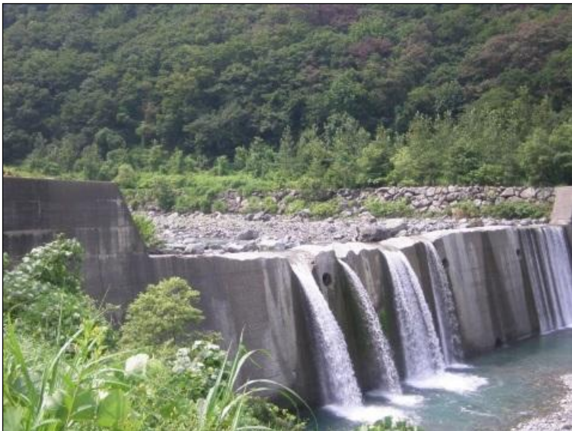
写真-1 水通し天端の摩耗（健全度 B）の例
