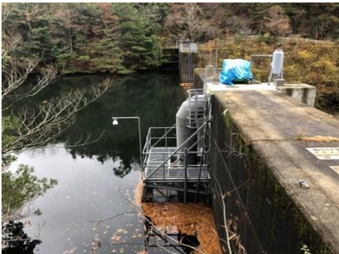
写真-5 サイフォン方式による取水設備設置例
