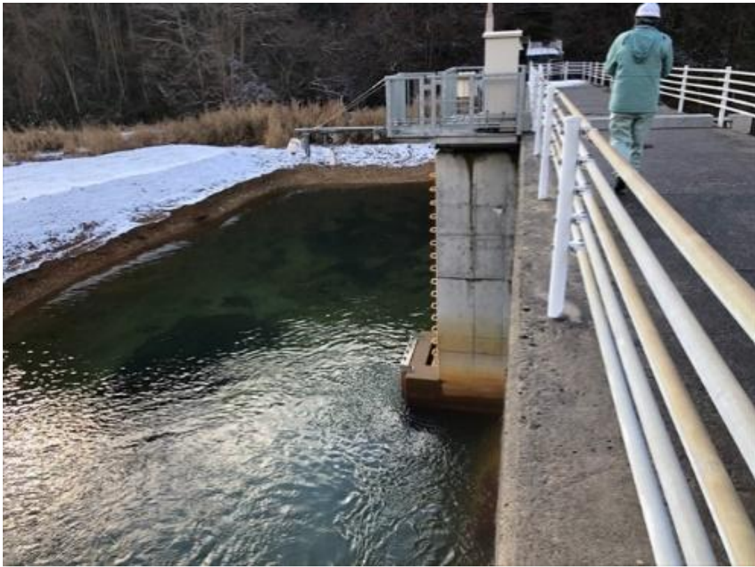
写真-2 堤体穴あけ方式による取水設備設置例
