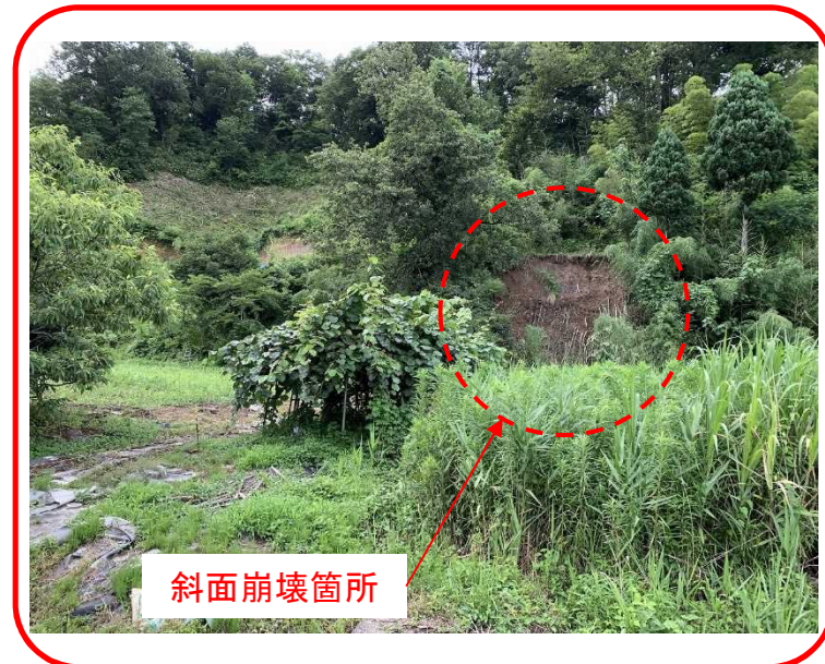
① 斜面崩壊発生箇所 【R5.7.13撮影】
