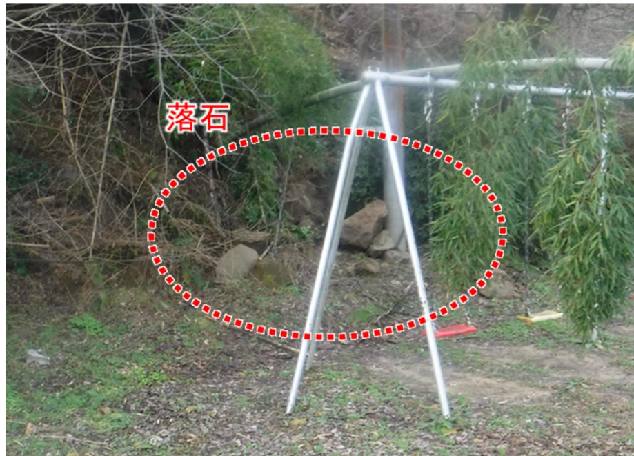
①斜面崩壊発生箇所
