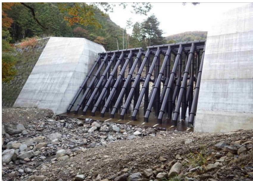
事例 1：透過型砂防堰堤（相模川流砂系）
