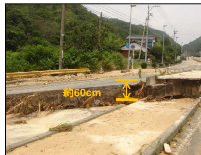
上勝坂橋の被災状況
