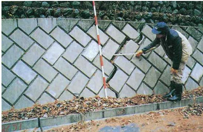
道路擁壁に生じた亀裂
