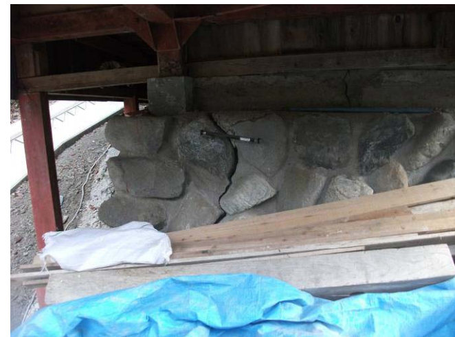
基礎に生じた亀裂
