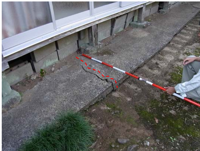
家屋コンクリート部に生じた亀裂
