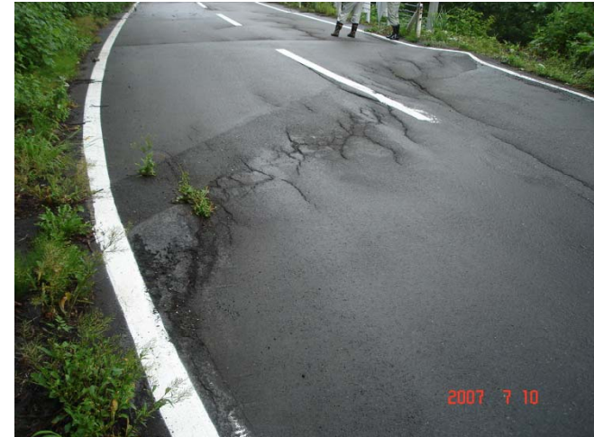
道路に生じた段差
