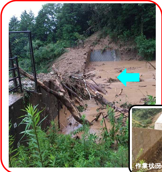
土石流発生直後 (R2.7.7撮影)
