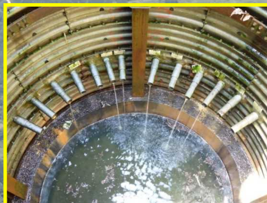
同地区内の既設集水井工
