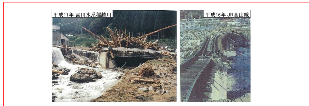
図 7-3 流木の閉塞による被害実績
