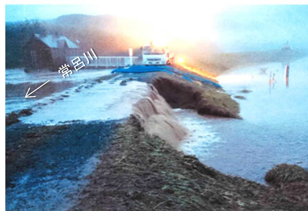
越水による堤防の法崩れ(常呂川)
