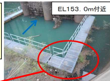
発電取水用除塵フロート
