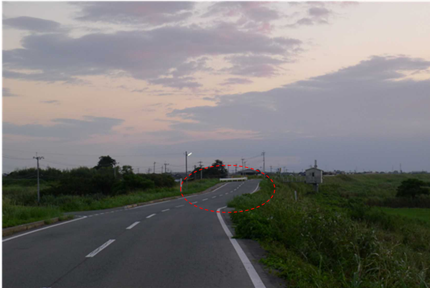
沈下により天端が低くなった箇所の例
