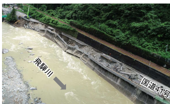
国道41号 道路崩壊 （岐阜県下呂市）
