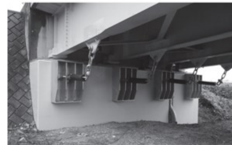
▲落橋防止装置を設置した国道50号の岡井高架橋(筑西市)
