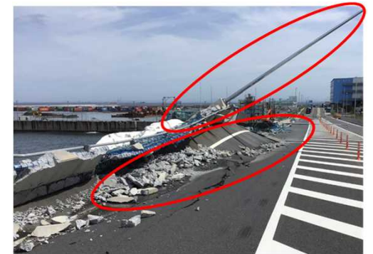
船舶の衝突による橋梁損傷 (通行止め)(横浜港南本牧)
