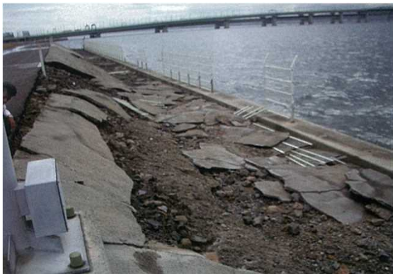
神戸港六甲沖処分場西護岸(上)及び 関西国際空港C護岸の被災状況(下)
