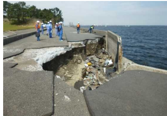
護岸損傷 (横浜港金沢区福浦)
