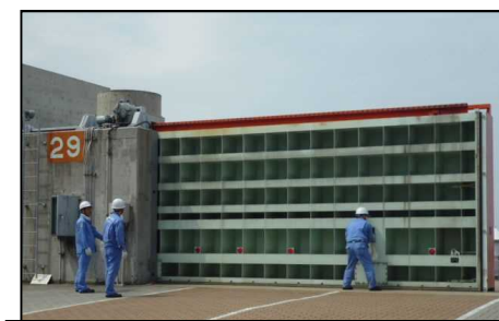
現場操作員による陸閘閉鎖(大阪府)
