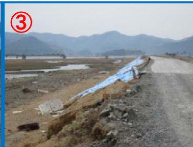
③ 津波は堤防を越波。橋桁、護岸、舗装も流失。（L3k付近）
