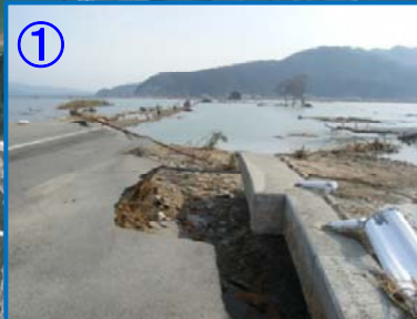
① 釜谷地区破堤状況。（R4.5k付近）
