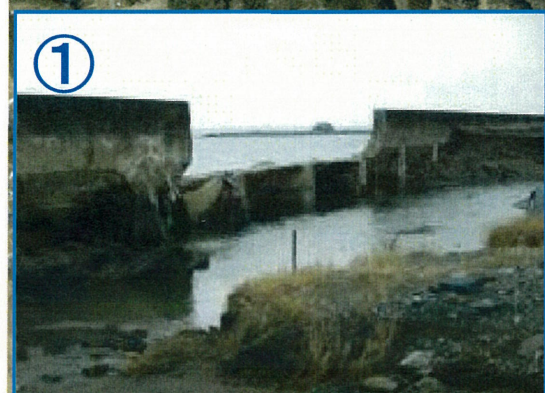
特殊堤が一部流出。 (R0.3k付近)
