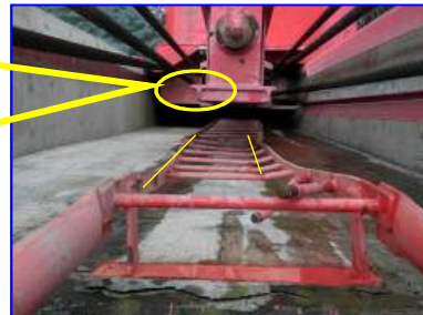
<ステップ（丸鋼）の破断>
