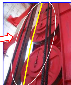
戸当りレール曲がり
