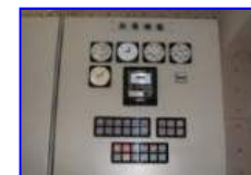
予備発電設備状況（損傷なし）
