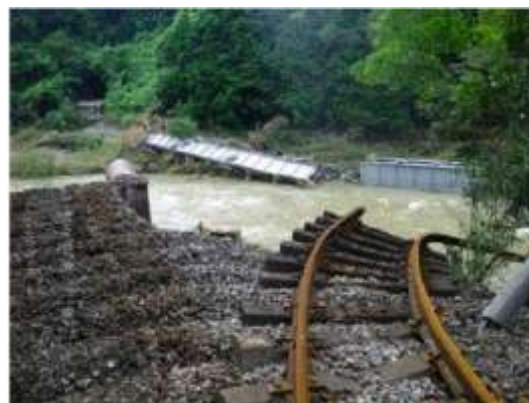
平成 22 年豪雨による JR 美祢線の橋梁流出状況 107)
