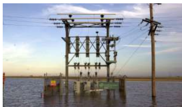
浸水による電力施設の損傷
