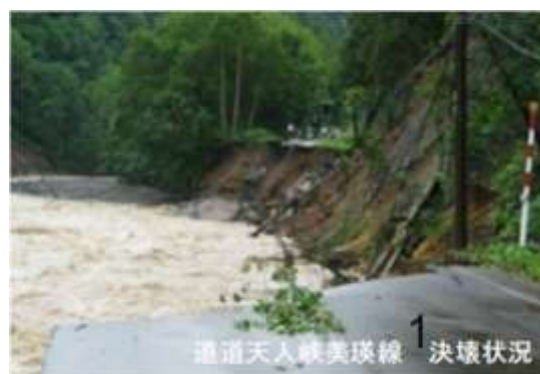
平成 22 年豪雨による道路寸断状況
