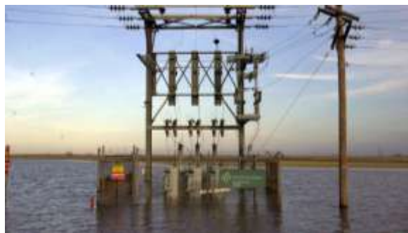
2005 年ハリケーン・カトリーナ 水害による電力施設の損傷 25)
