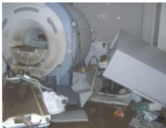
平成 17 台風 14 号による大淀川の氾濫 潤和会記念病院の엑스線室 MRI の被災状況 13)
