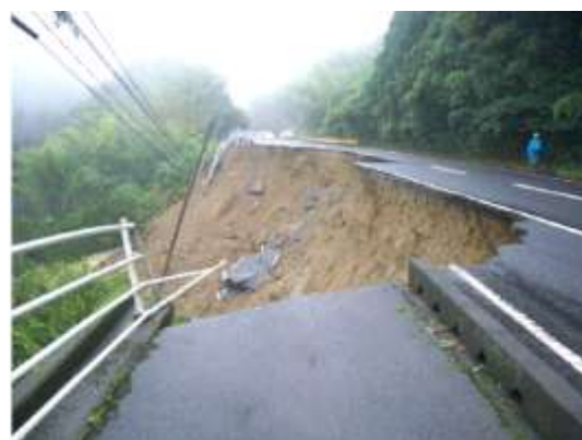
平成 22 年豪雨による法面崩壊状況
