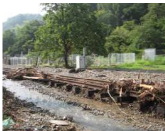
平成 21 年豪雨による JR 姫新線の盛土流出状況
