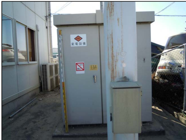
被災し、修繕した高圧受変電設備
