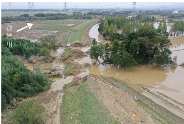
都幾川0.4k右岸 決壊箇所
