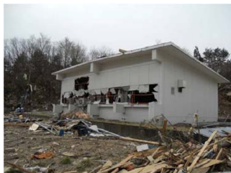
津波により被災した通信設備
