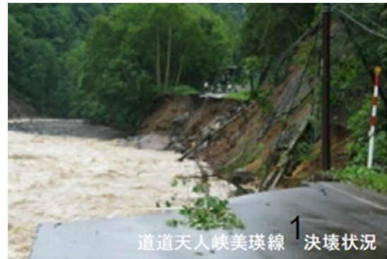
平成22年豪雨による道路寸断状況
