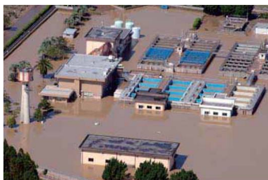
冠水して一面泥水に浸った富吉浄水場 125)
