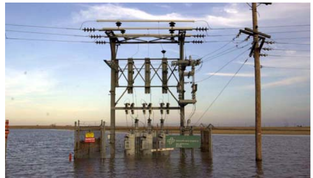
浸水による電力施設の損傷
