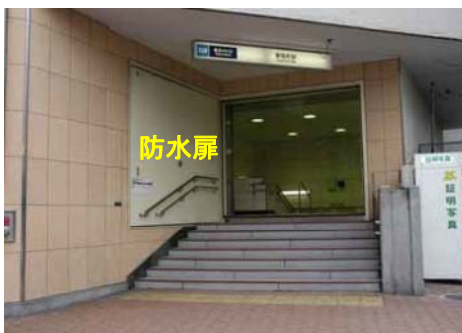
地下鉄の出入口における浸水対策 105) (防水扉)
