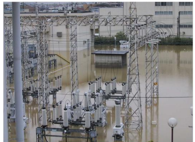
浸水による変電所の冠水
