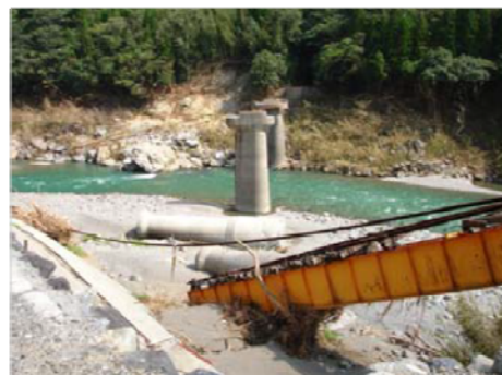
平成17年豪雨による 高千穂線の橋梁流出状況 116)
