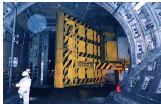
トンネル内浸水対策 105) (防水ゲート)
