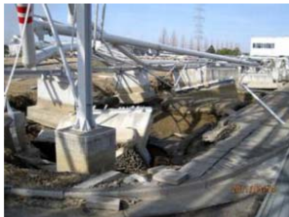
製造設備被害状況（配管・架構） 122)
