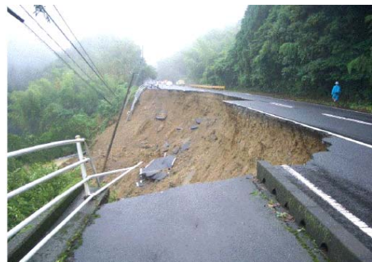
平成22年豪雨による法面崩壊状況
