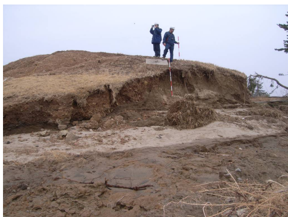
◆河口市：堤防先端部分の侵食状況
