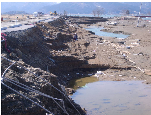
◆堤内側への越流によると考えられるのり面の侵食と落ち堀の形成
