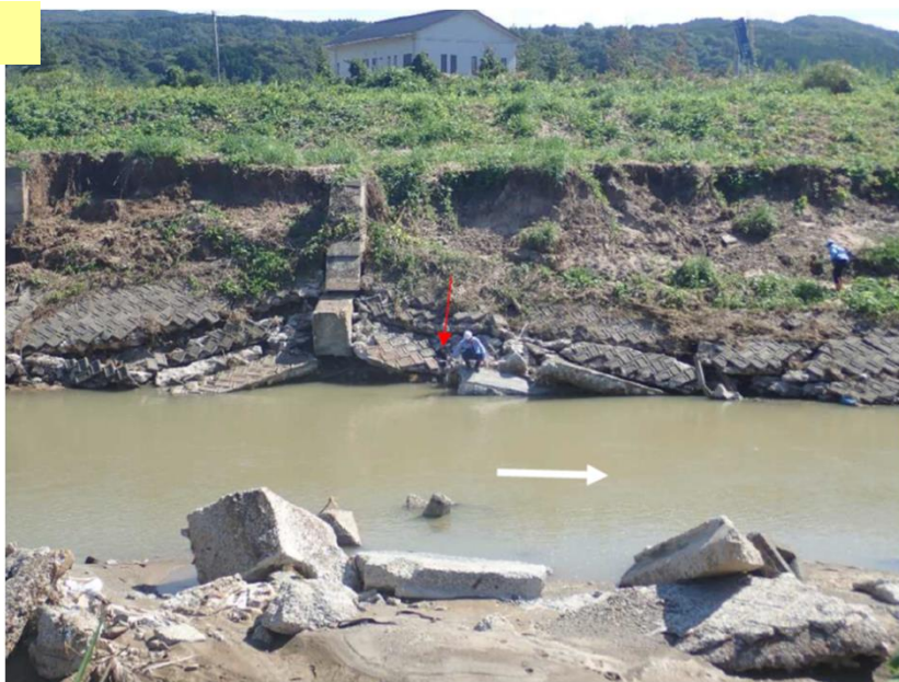
地震で隆起(3.5m)した場所で護岸が損傷
