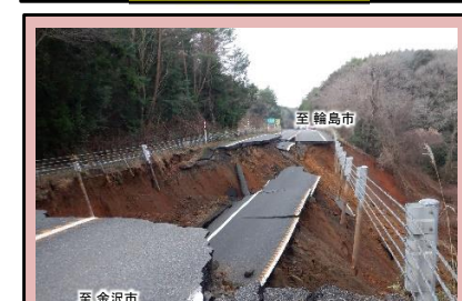
写真⑤ 能越自動車道の道路崩壊
