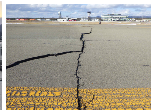
能登空港の被災(穴水町)
