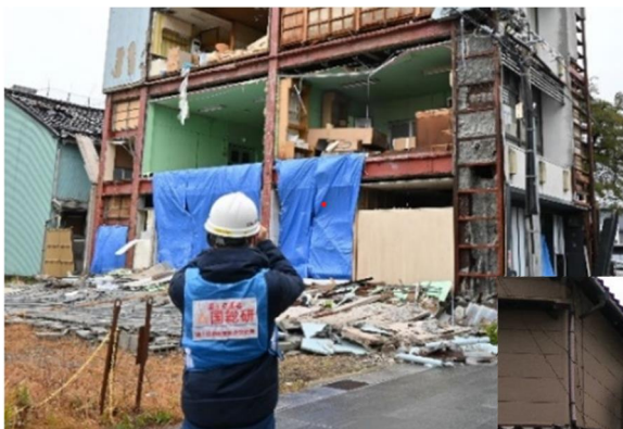
建築物の損壊状況(七尾市)
