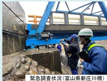
緊急調査状況(富山県新庄川橋)
