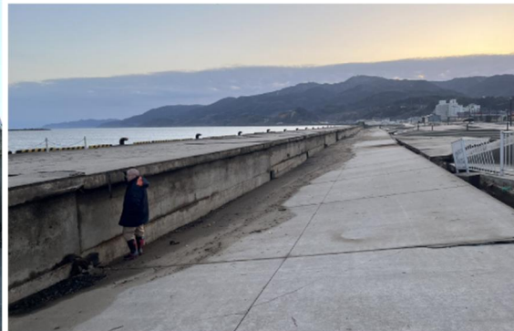
輪島港の被災(輪島市)
