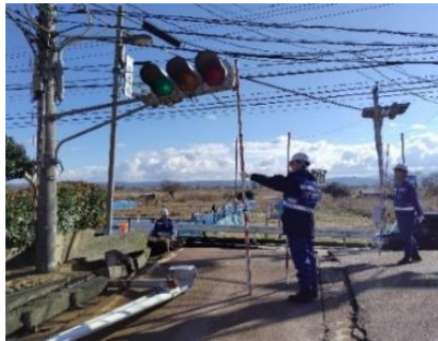
道路の被災状況調査 (石川県内灘町)
