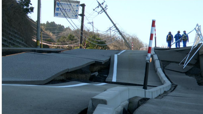
国道249号道の駅千枚田付近(輪島市)
