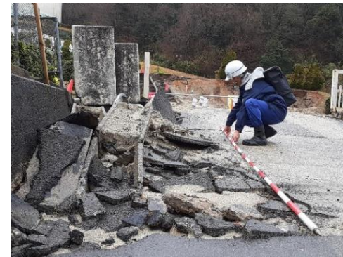
岩屋浄水場の被災(七尾市)
