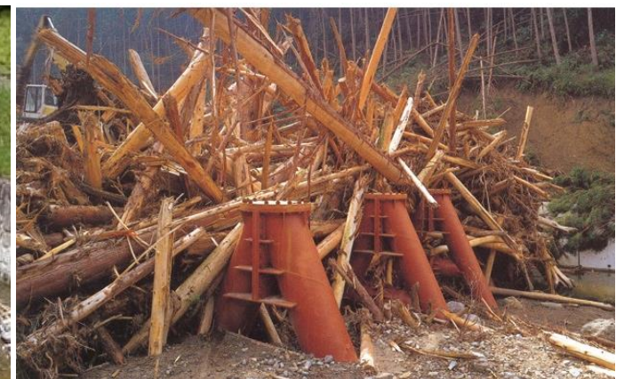
流木捕捉工(大分県中津市)
