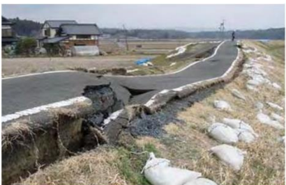
堤防の変状(決壊、沈下、亀裂)や流下能力の低下
