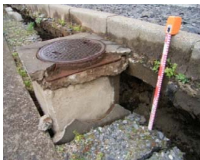
②沈下による段差
