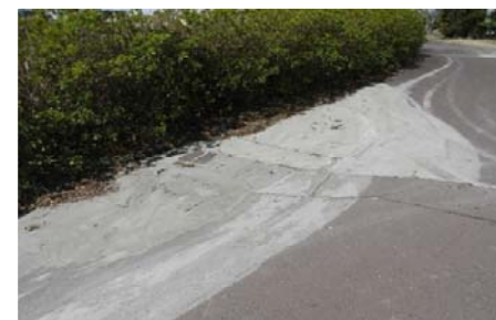
④通路液状化
