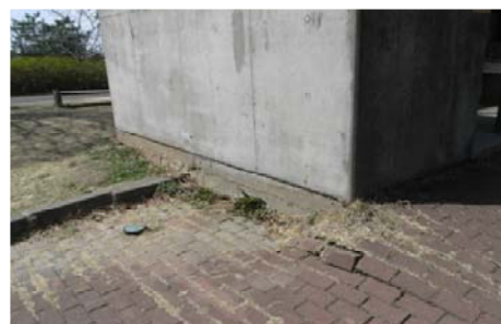
③トイレ周辺陥没
