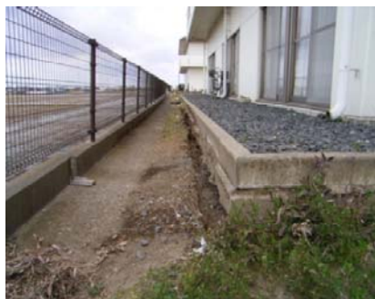
①沈下による段差
