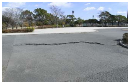
①舗装の亀裂
