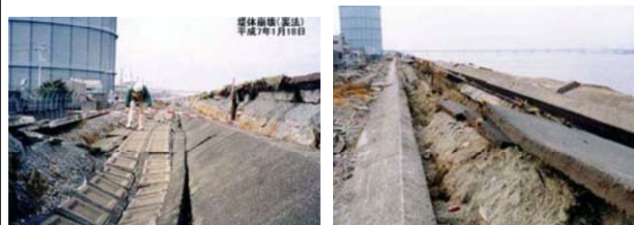
阪神・淡路大震災における淀川の堤防の被災状況【出典：淀川河川事務所HP】
