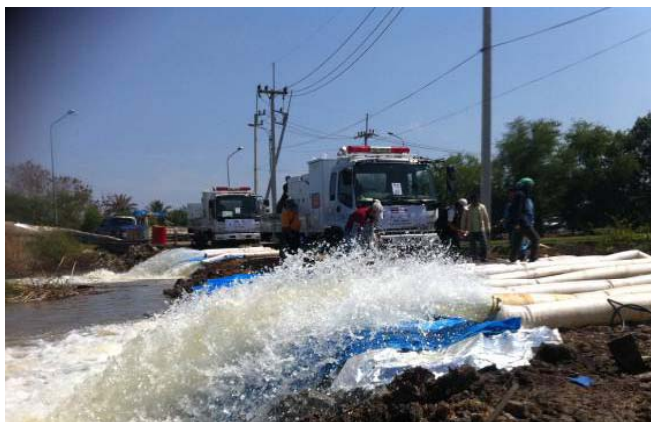
派遣した排水ポンプ車
