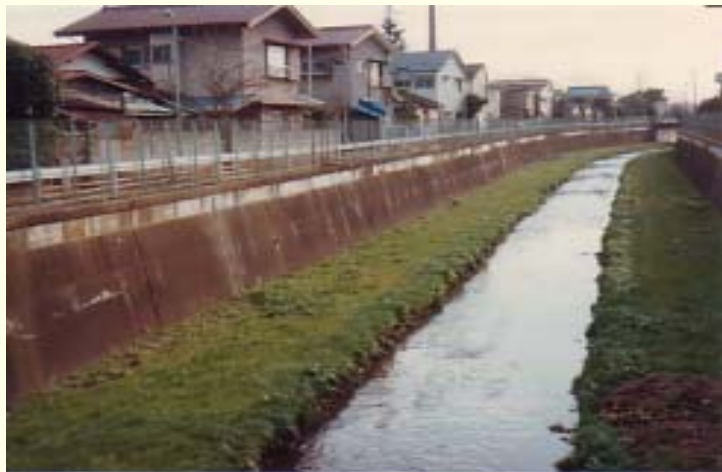
家屋連担写真(滝の上橋下流S55):残堀川
