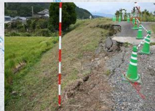
漏水により堤防法面崩れ
