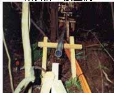
伸縮計の設置例
