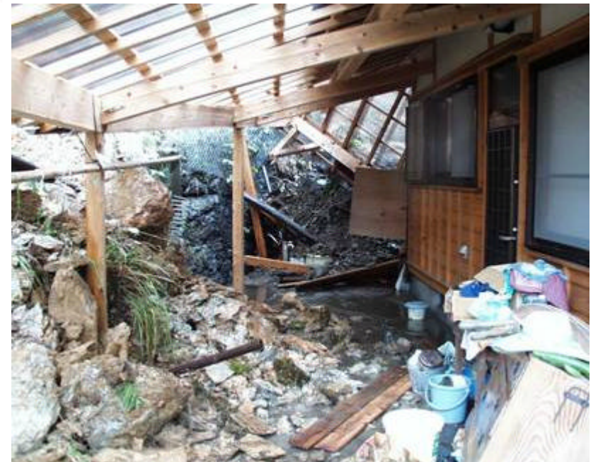
高知県土佐町東石原崩壊箇所 (一部損壊1戸)
