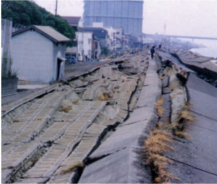
地震による堤防の被災状況
