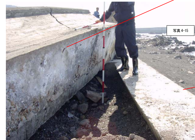
被災箇所南側端部のパラペット及び堤体打継目状況
