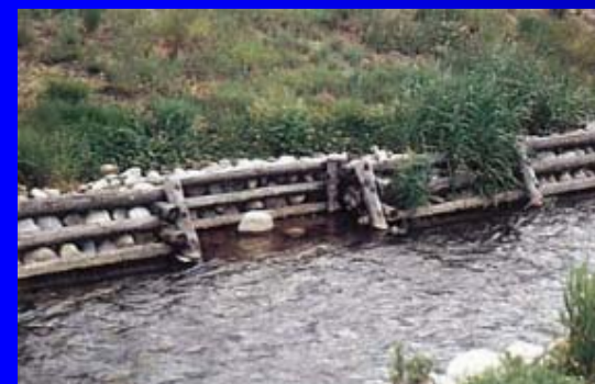
木工沈床（農具川：長野県）
