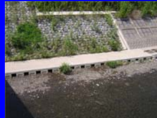
魚巣ブロックの前面に土砂が堆積した例
