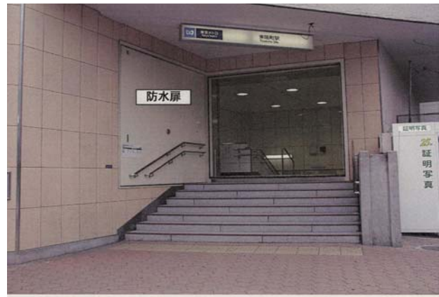
防水扉の設置(地下鉄)
