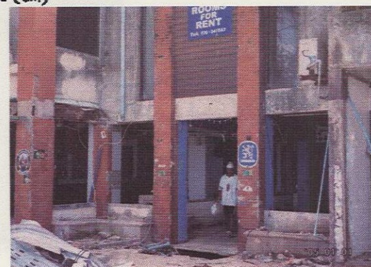
残存するコンクリート柱
