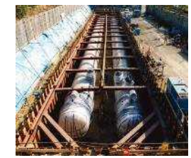
耐震性貯水槽
